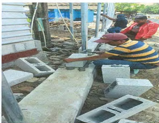
Foto 3: ASENTAMIENTO DE CERRAMIENTO PERIMETRAL
